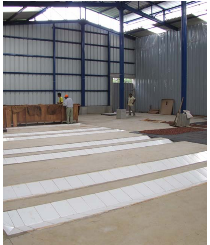
Neue Weiterverarbeitungsanlage zur Fermentierung, Trocknung und Lagerung des Kakaos.
